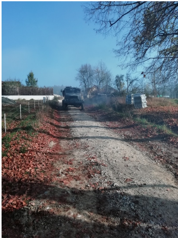
stav pred opravou
